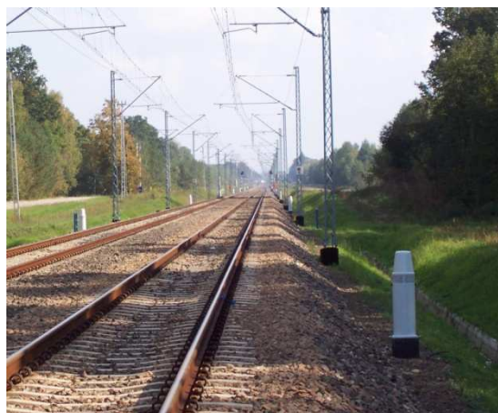
Fot.4. Sposób montażu urządzeń UOZ-1 na linii kolejowej (fot. Marek Stolarski)
