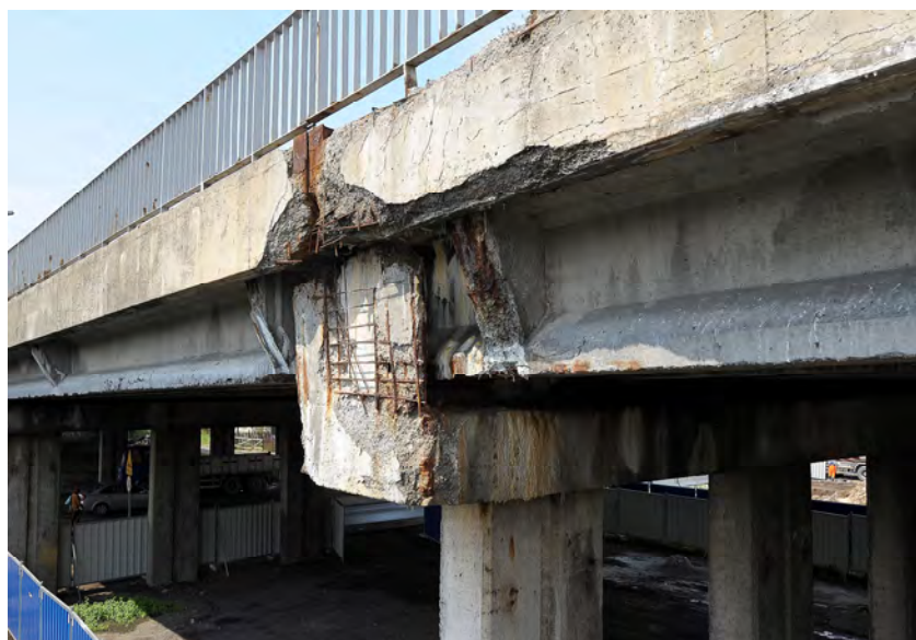
Fot. 3. Korozja konstrukcji mostowej (fot A. Marecki 2010)
