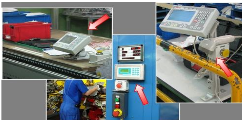
Rys. 3. Pulpity sterujące i stanowiska kontroli systemu MES[1]
