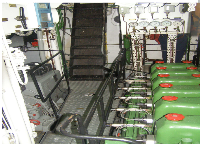
Fot. 6. Siłownia okrętowa, jedno z pomieszczeń o największym ryzyku pożarowym. Uwagę zwraca nagromadzenie na małej powierzchni licznych systemów i urządzeń oraz ograniczone możliwości poruszania się wśród nich
