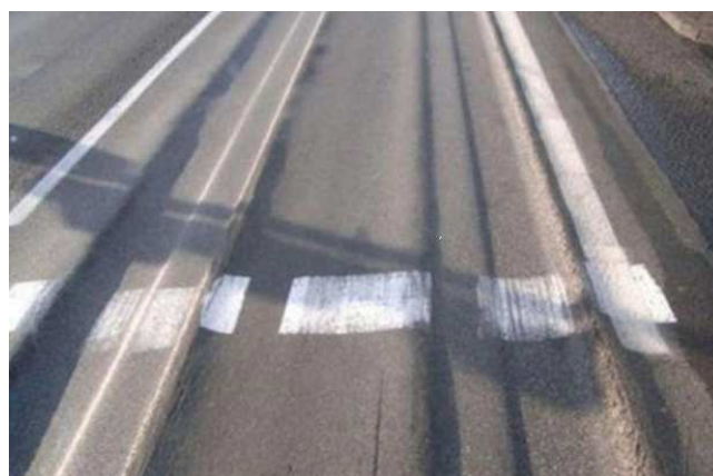
Rys. 5. Koleiny – efekt przeciążenia pojazdów kołowych na drogach asfaltowych
