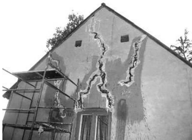
Rys. 6. Pęknięte ściany domów sąsiadujących z drogami o regularnym ruchu tranzytowym kontenerowych zestawów transportowych
