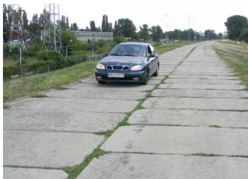
Rys. 7. Odcinek pomiarowy z nierównościami.
