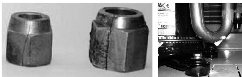
Rys. 3. Nieszczelność instalacji: a) na skutek pękniętej nakrętki, b) nieszczelność na rurce [4]
