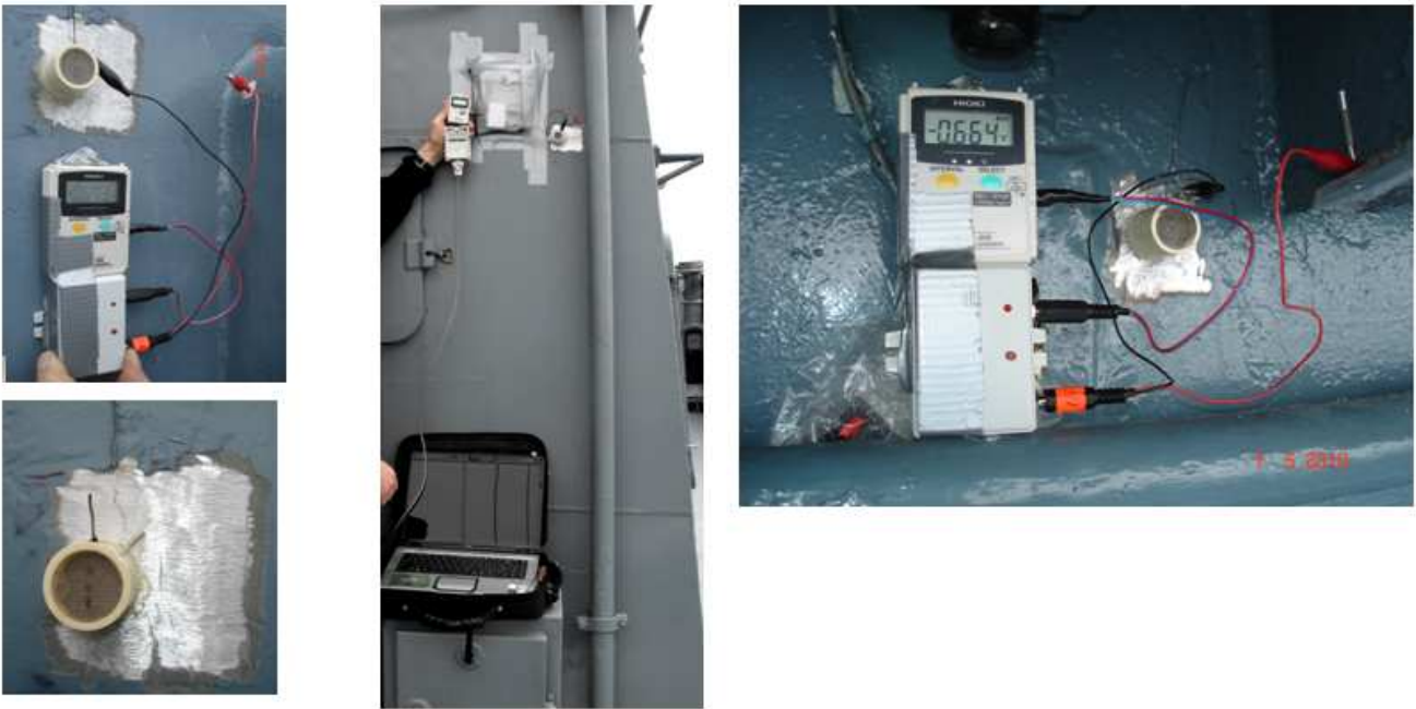
Rys.4.OSDK montowany na wybranych obszarach (pękających) aluminiowej (stop 7020) okrętowej nadbudówki okrętu projektu 620, którego 40-metrowa 3-pokładowa nadbudówka to badany obiekt zestawem pomiarowym w składzie: Data Logger (rejestrator napięcia z własną pamięcią i źródłem zasilania) seperatorem i mini celką elektrochemiczną z elektrolitem, która mocowana była na pęknięciu materiału rodzimego i złącza spawanego [Zgłoszenie Patentowe nr. P.394421 z 2011 ].
