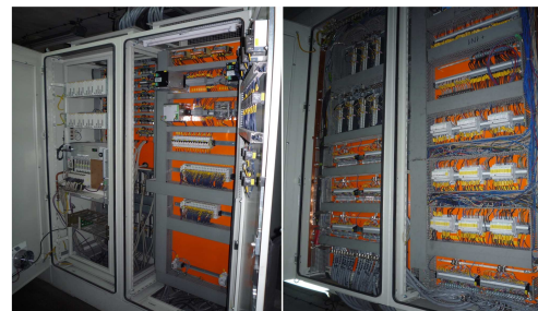
Rys. 4. Widok nowej szafy sterującej dla napędów głównych linii walcowniczej po modernizacji. Po lewej sterownik LOGIDYN D2 firmy ALSTOM wraz z modułami wejść, wyjść cyfrowych. Po prawej wyprowadzenia przewodów z kart impulsów do bloków tyrystorowych
