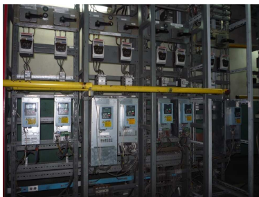
Rys. 3. Widok szaf sterowniczych dla napędów rejonu pieca po modernizacji
