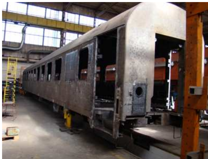
Rys. 6. Pudło wagonu pasażerskiego po usunięciu poprzedniej powłoki malarskiej, produktów korozji i uszkodzeń zewnętrznych oraz przygotowywanego do procesu śrutowania. [fot. autora]
