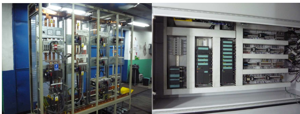
Rys. 8. Systemy kontrolujące prace skrzyń wodnych, rolek dociskowych oraz formera. Do bezpośredniego sterowania silnikami napędów rolek i formerów zostały użyte przekształtniki firmy VACON z serii NX.
