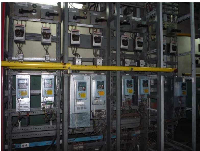
Rys. 7. Widok szaf sterowniczych dla napędów rejonu pieca po modernizacji.
