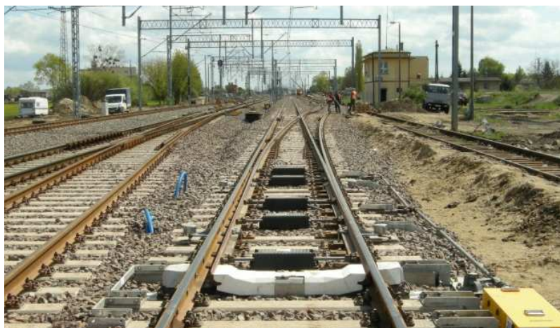
Fot. 1. Rozjazd zwyczajny prawy o promieniu 760 m
