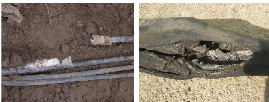
Rys. 4. Uszkodzenia kabla nN w skutek drzewienia wodnego oraz niewłaściwego montażu mufy
