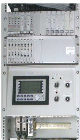
Rys. 3. Fragment stojaka z aparaturą sterującą sygnalizacją przejazdową RASP-4f
