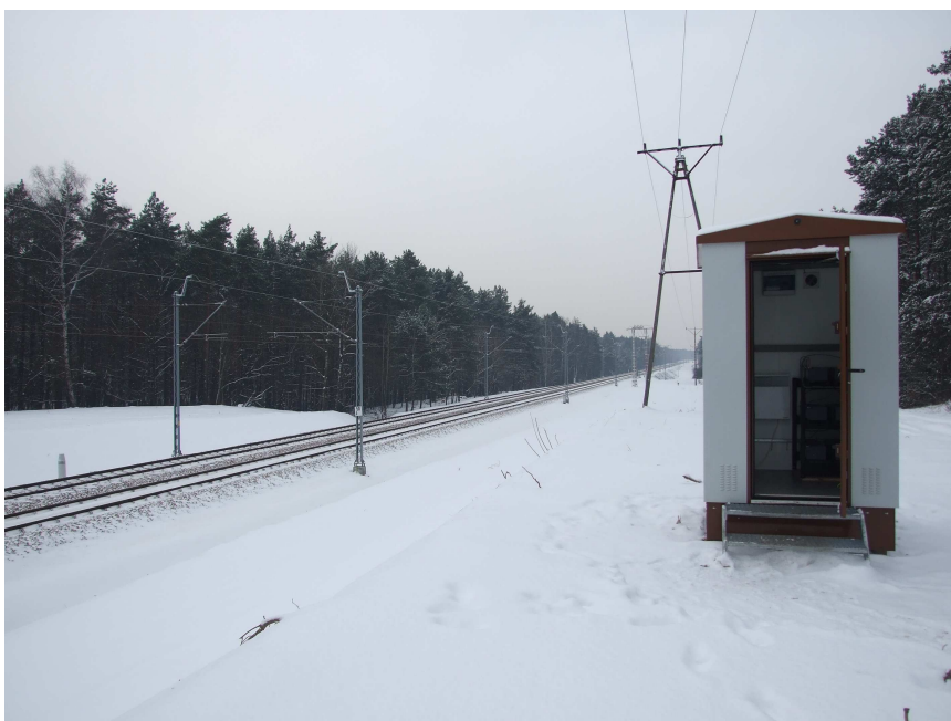
Fot. 4. Kontener KUOZ na linii E65
