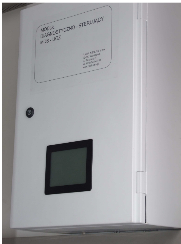
Fot. 7. Moduł MDS-UOZ (sterownik kontenera UOZ).
