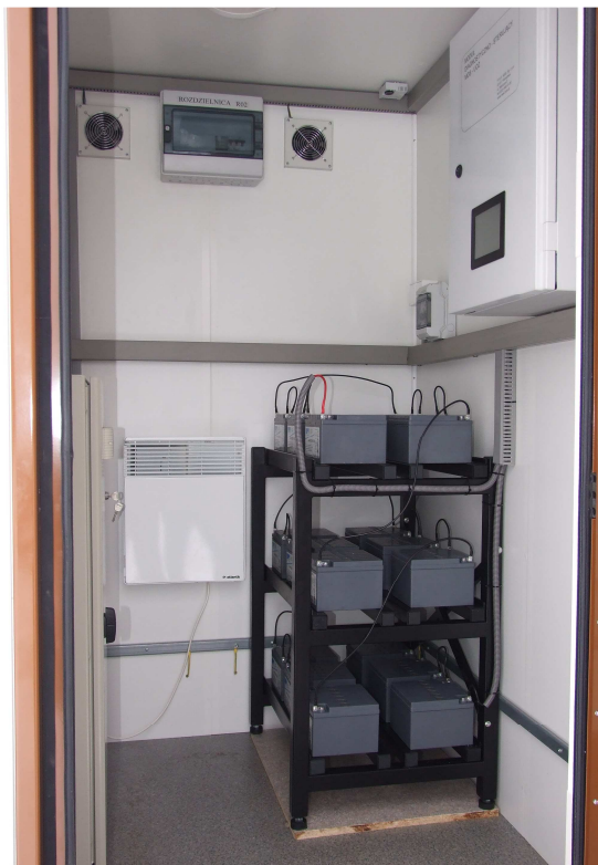
Fot. 6. Wnętrze kontenera KUOZ
