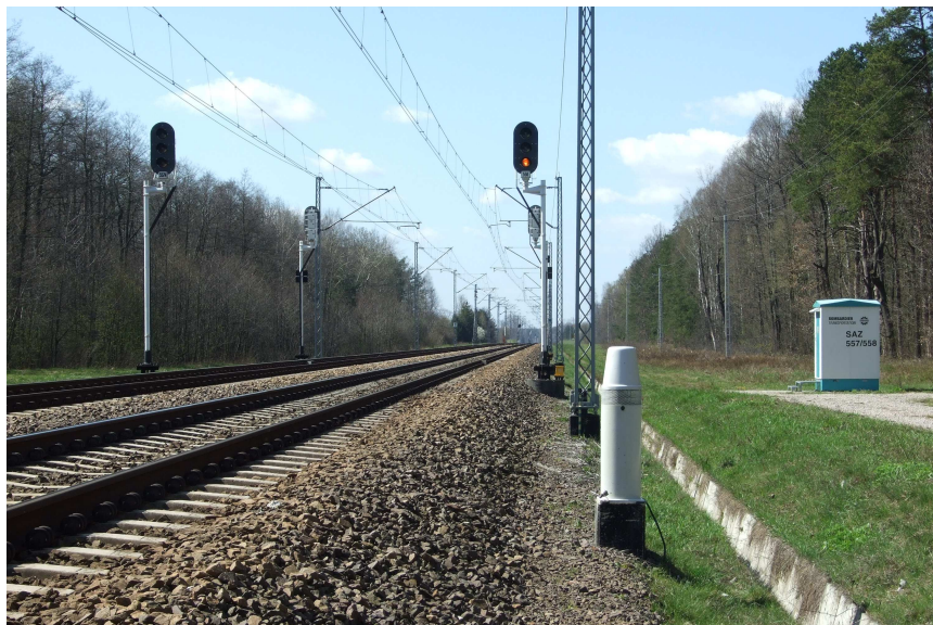
Fot.3. Urządzenie UOZ-1 zainstalowane na linii kolejowej E20 i kontener samoczynnej blokady liniowej SHL-12
