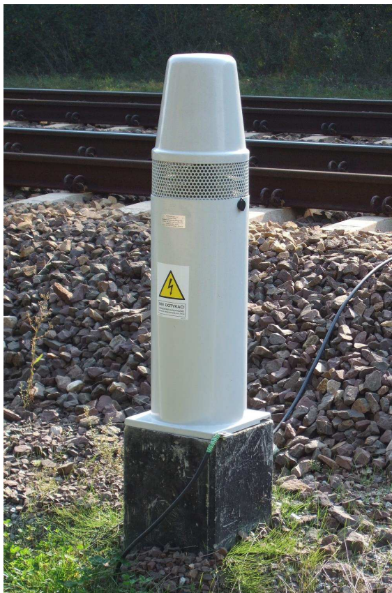
Fot.2. Urządzenie przytorowe UOZ-1
