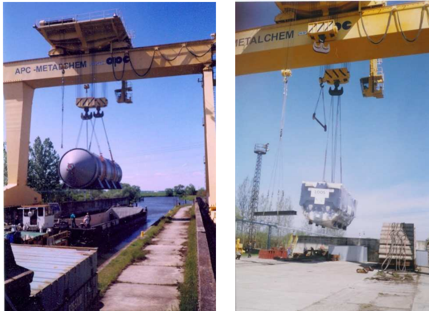
Rys. 8. Załadunek zbiornika o średnicy 4,8m, długości 16m, masie 160 ton oraz rozładunek pieca grzewczego o masie 85 ton
