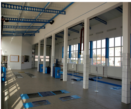
Rys.4. Widok linii podwójnej firmy Unimetal (osobowej i uniwersalnej)
