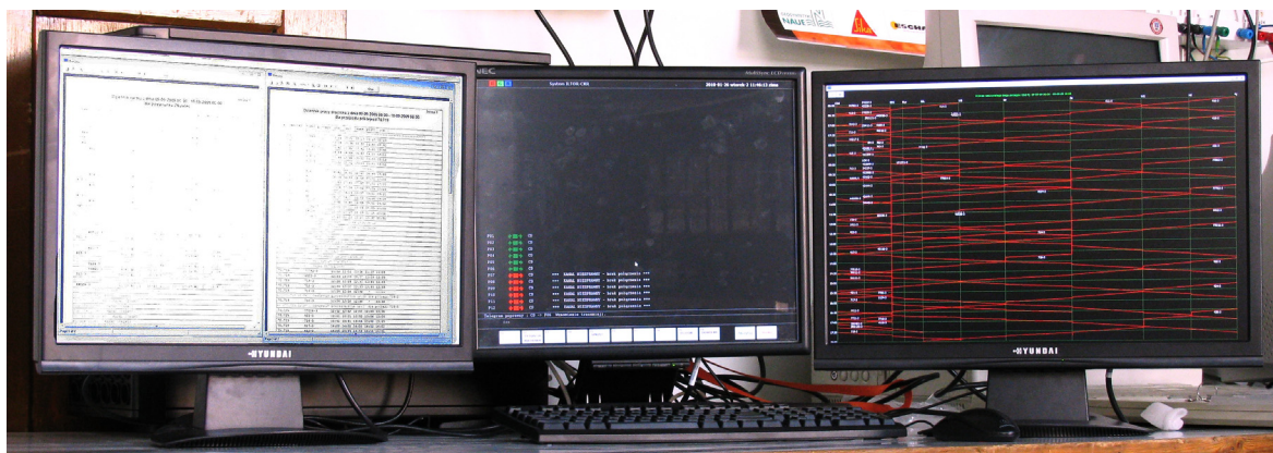
Rys. 1. Ogólny widok stanowiska kontroli dyspozytorskiej stanowiska dydaktyczno-badawczego KSR Sosna w laboratorium sterowania ruchem kolejowym WTPW.
