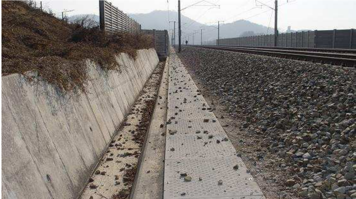
Rys. 2 Zjawisko wywiewania ziaren tłucznia podczas przejazdu pociągu z dużą prędkością.
