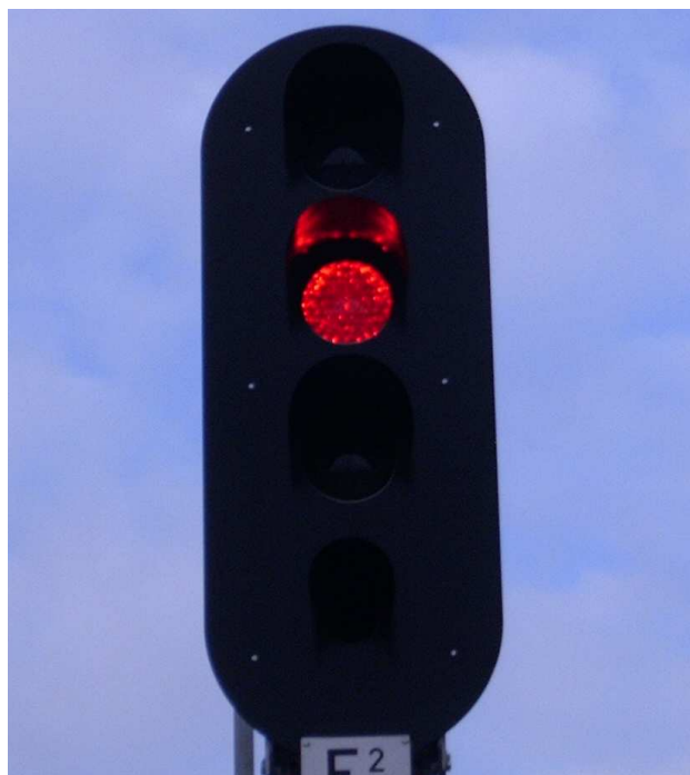
Fot. 3 Głowica semafora prztorowego systemu ZSB 2000 z diodowymi punktami świetlnymi.
