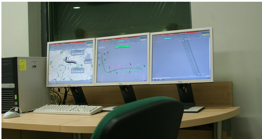
Fot. 3. Monitory kontrolujące pracę systemów bezpieczeństwa w tunelu na stacji Dworzec Główny Tunel – na środkowym monitorze odcinek zajęty przez tramwaj zaznaczony na fioletowo (foto: M. Wojtaszek)
