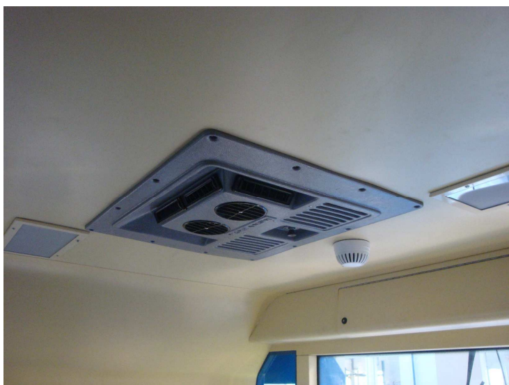
Rys. 8. Przedstawiono lokalizację czujki dymowej typu OSD23 w przedziale wagonu pasażerskiego (lokalizacja przejściowa)
