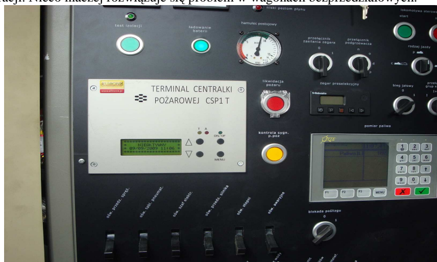
Rys. 7. Widok terminala centralki pożarowej typ CSP1TA (szafa sterownicza wagonu)
