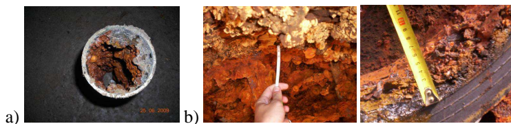
Rys. 7. Skorodowany przewód wodociągowy wykonany z żeliwa o średnicy: a) DN100, b) DN 1200
