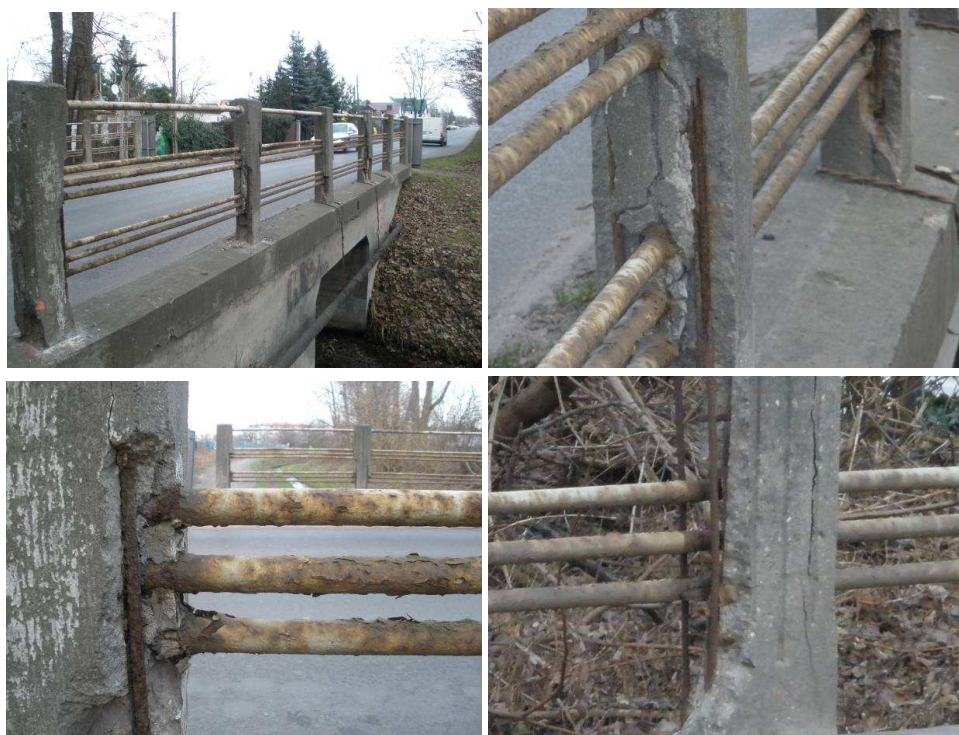
Rys. 6. Zniszczenia spowodowane korozją na mostku w ulicy Lucerny
