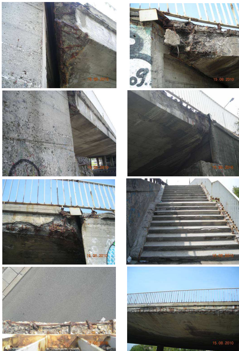
Rys. 5. Zniszczenia spowodowane korozją na wiadukcie nad Aleją Stanów Zjednoczonych
