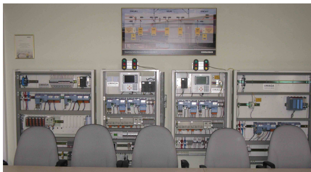
Rys. 5. Liniowe i stacyjne punkty sterowania komputerowej blokady liniowej SHL-12 z powtarzaczami semaforów odstępowych oraz panelami diagnostycznymi EZG-2101
