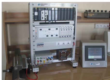
Rys. 13. Widok stanowiska licznikowego systemu kontroli niezajętości typu SKZR
