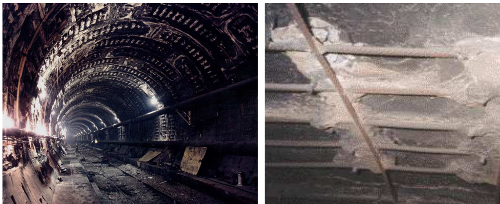
Rys. 1. Pożary w tunelach: skutki pożaru w „Eurotunelu” i betonowa obudowa tunelu po wystąpieniu „spallingu” [16]
