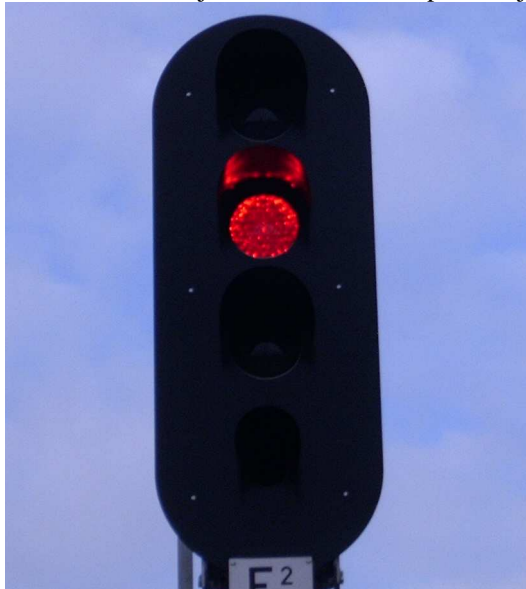
Fot. 3 Głowica semafora przytorowego systemu ZSB 2000 z diodowymi punktami świetlnymi.
