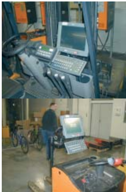
Zdjęcia zainstalowanych urządzeń
