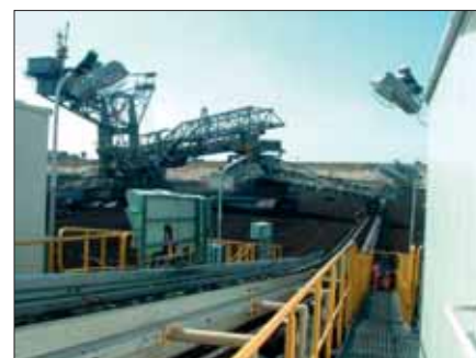
Fot. 1. Ciąg węglowy z przenośnikiem o regulowanej prędkości taśmy 1,5 m/s – 6,0 m/s w odkrywce „Drzewce” w KWB „Konin”. (fot. archiwum Autora).
